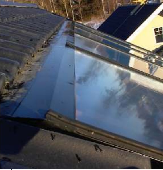
(kuva 3 tiilikattoon upotettu keräin Tx 2009-4)
